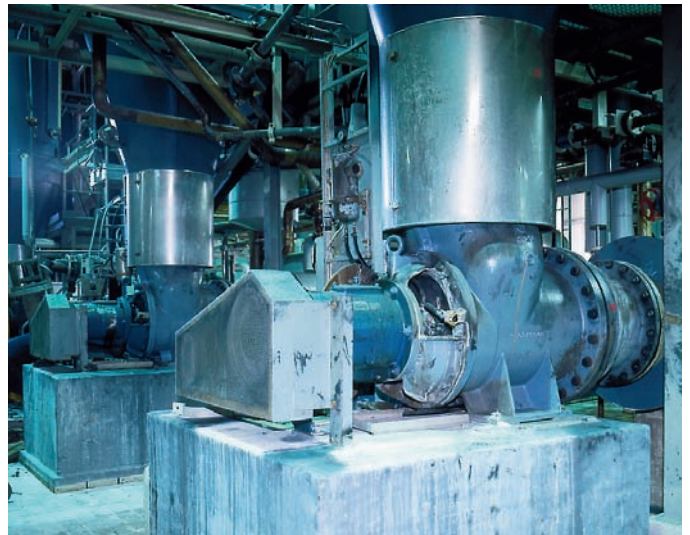
Umwälzpumpen Typ RSU in einer Anlage zur Aufkonzentrierung der Dünnsäure.
