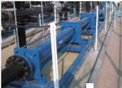
Многофазная дожимающая компрессорная установка, Таиланд
