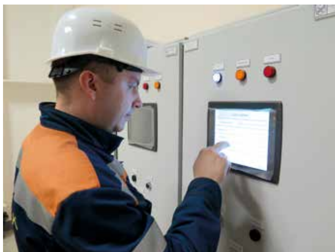
Пост местного управления системы бесперебойного питания
