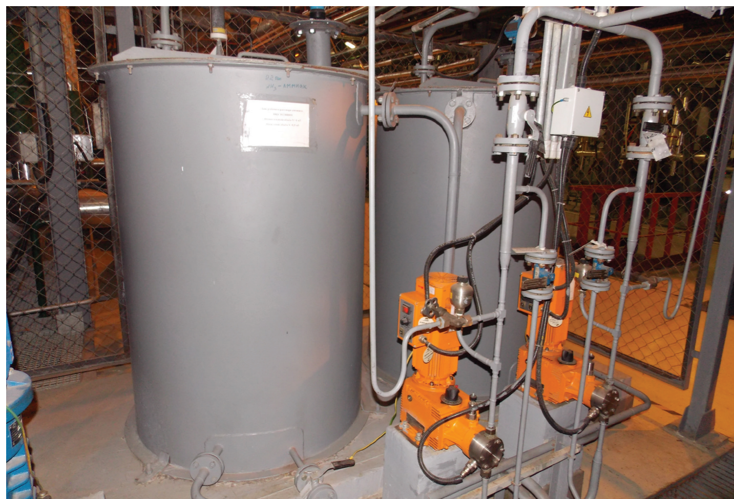
Автоматическая система подачи аммиачной воды, выполненная на основе дозирующих насосов Hydro/2
