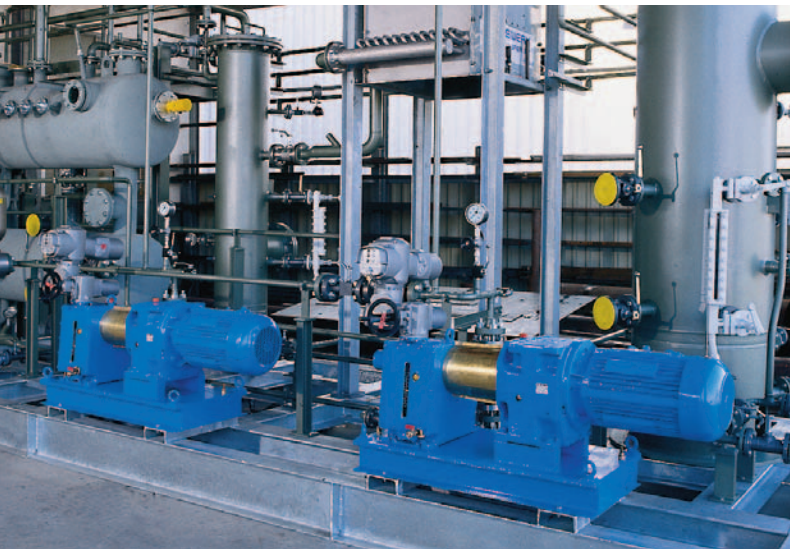
Дозирующие насосы ORLITA® в производственном процессе регенерации гликоля
