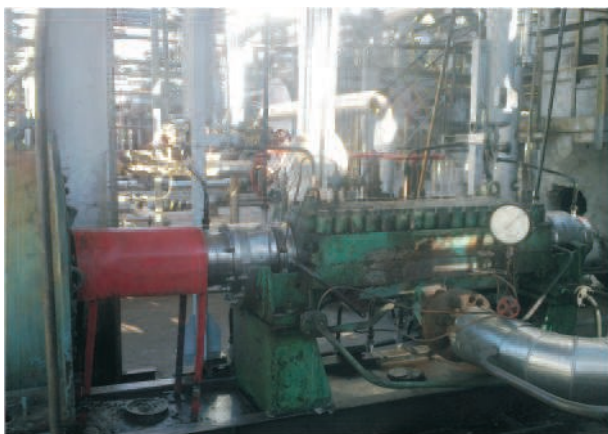
Насос НПС с БПУ в работе
