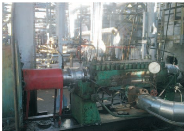
Насос НПС с БПУ в работе
