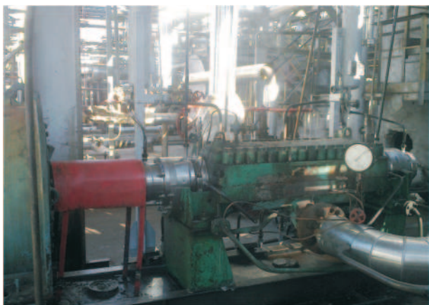
Насос НПС с БПУ в работе
